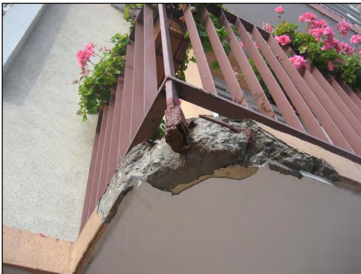
Scellement de pied de garde-corps mal positionné
